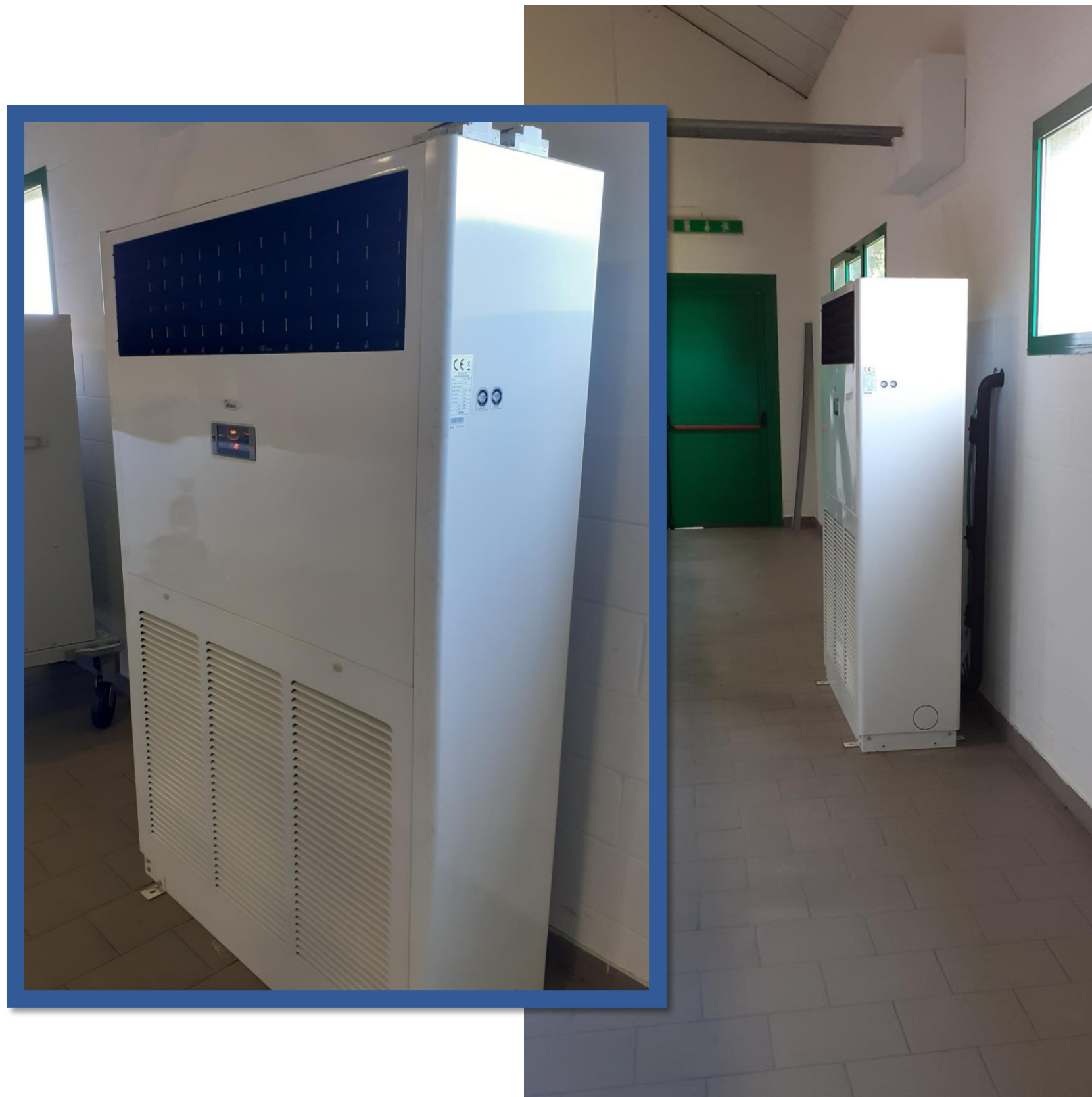
Climatizzatori installati (Mirano e Dolo)
