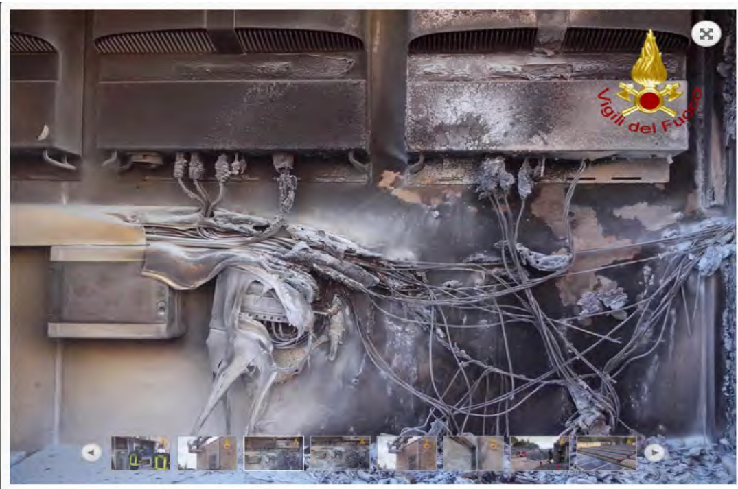
L'immagine mostra l'incendio sviluppatosi in un locale adibito all'alloggiamento degli inverter.
