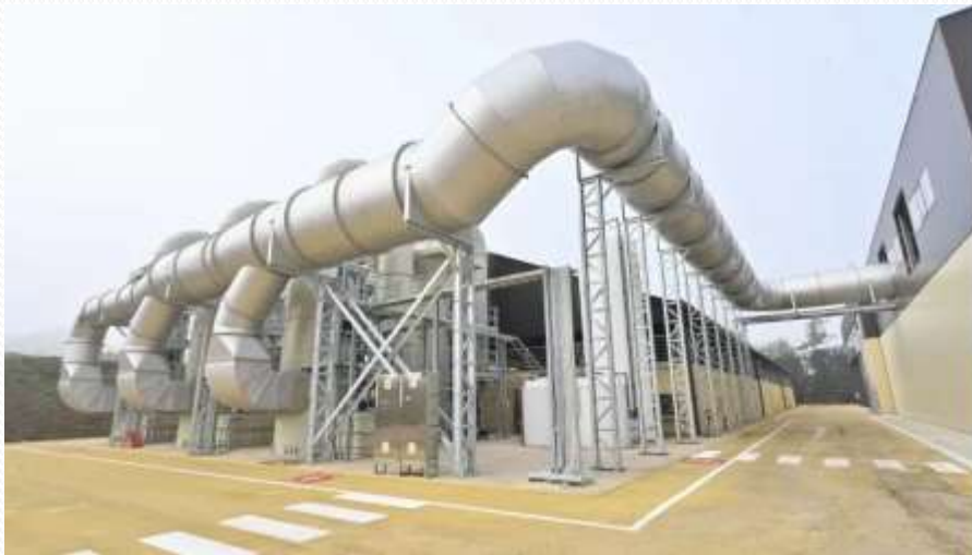
Impianti trattamento rifiuti organici ( umido)
