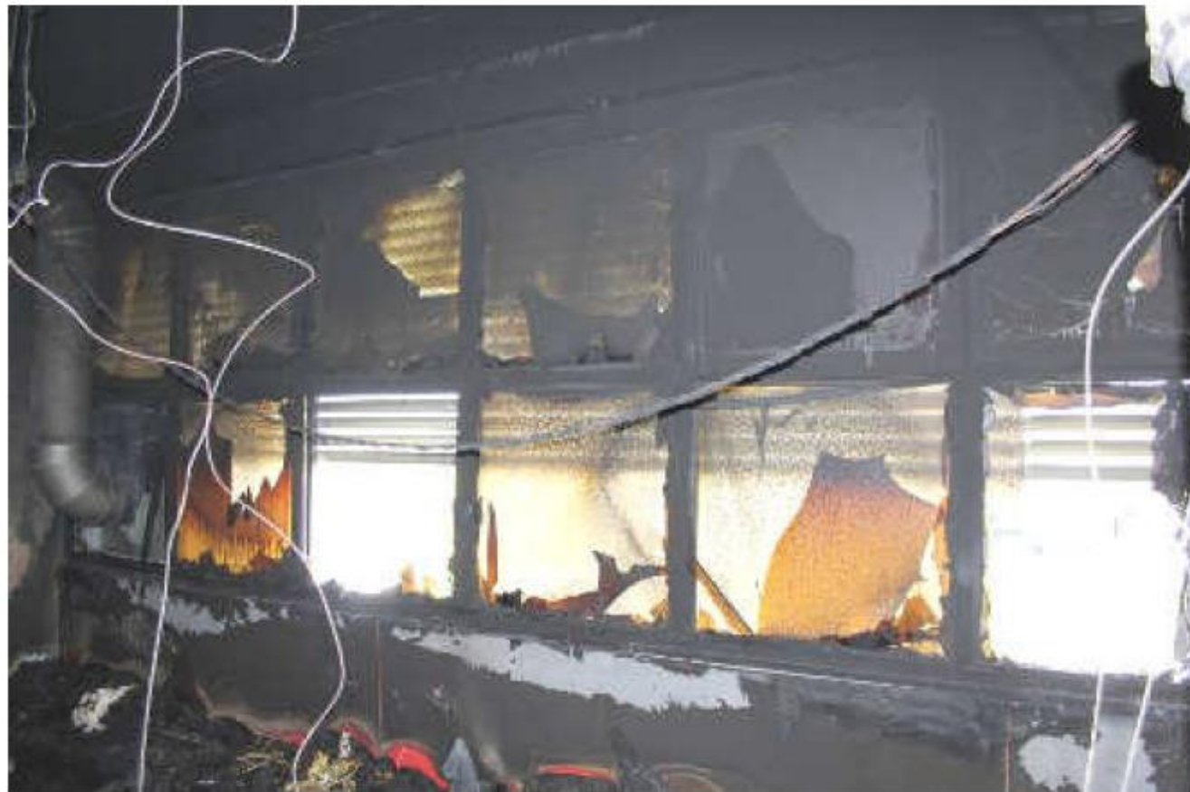
Vetri di finestre rotti a causa di una sollecitazione termica
