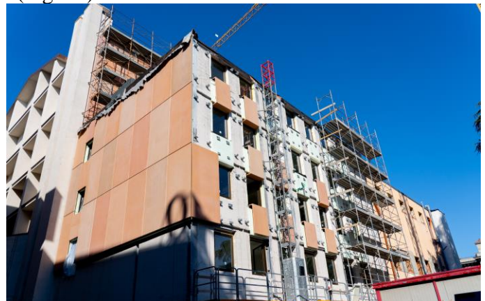
Figure 24. View of the changing rooms assembly. / Vista del montaggio dei pannelli dei camerini.
