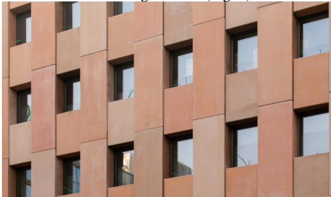
Figure 8. Detail of the cladding of the changing rooms façade. / Dettaglio del rivestimento di facciata del corpo camerini.
