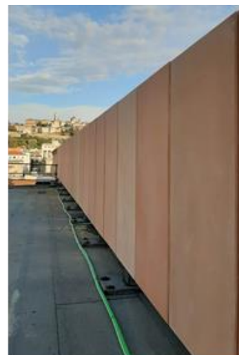
Figure 7. Cladding of the plant system on the roof. / Rivestimento del corpo impianti in copertura.
