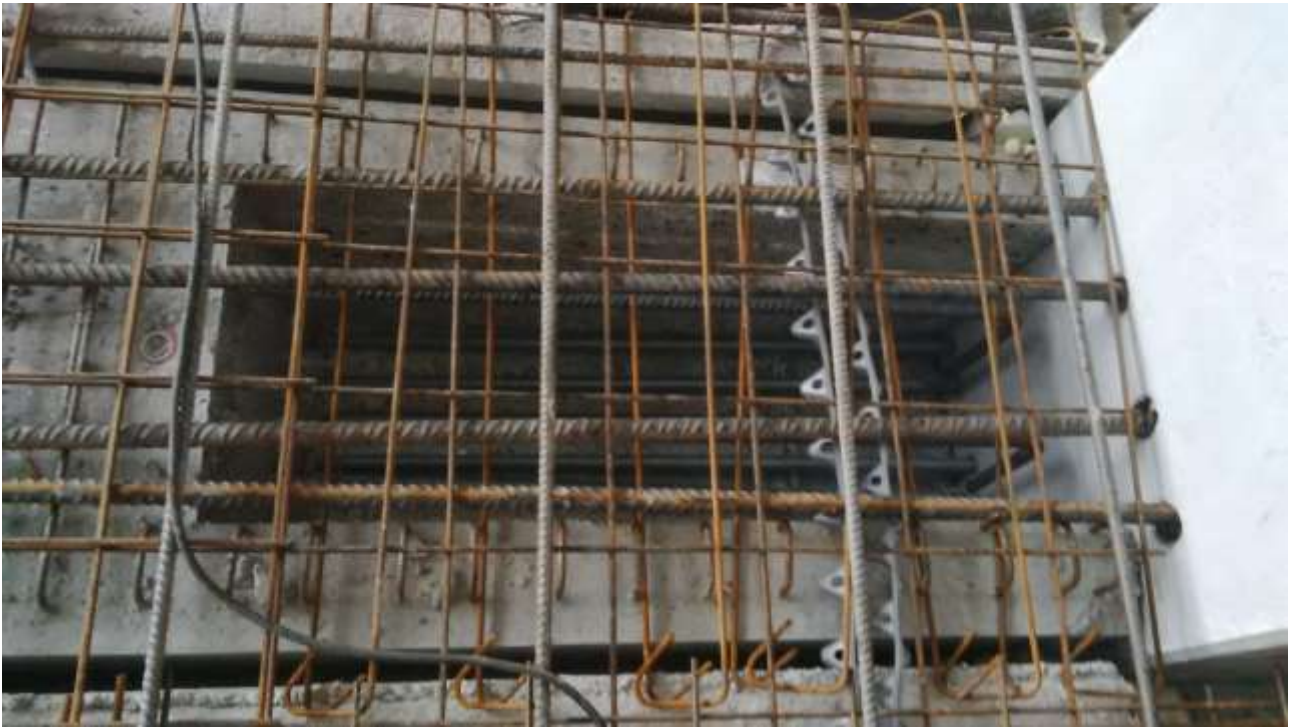
Figura 3 – Dettaglio della connessione rigida trave-colonna (Ampliamento dell'Aerostazione Lotto 4° di Orio al Serio BG, Imp. Sergio Milesi, ing. Stefano Knisel)
