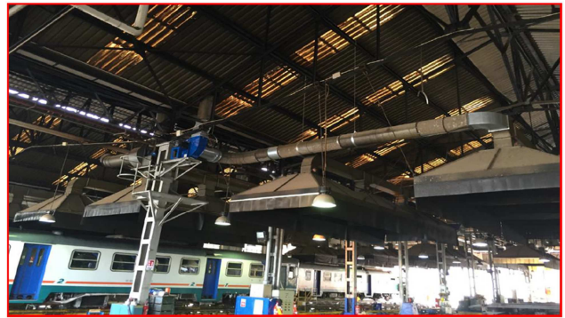
Figura 26 Tettoia con aspiratori fumi treni diesel
