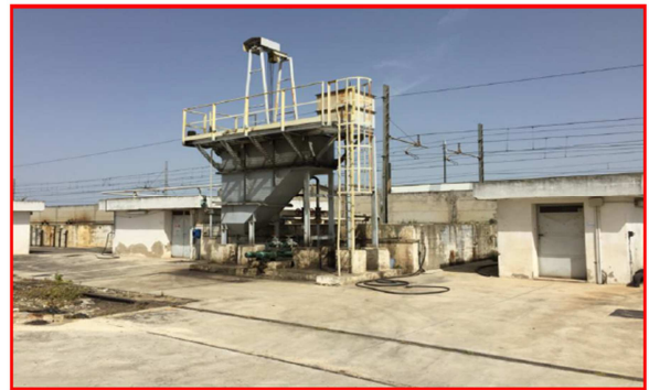
Figura 22 Impianto di depurazione
