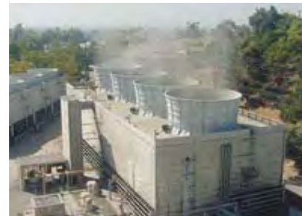
torri di raffreddamento/ condensatori evaporativi
