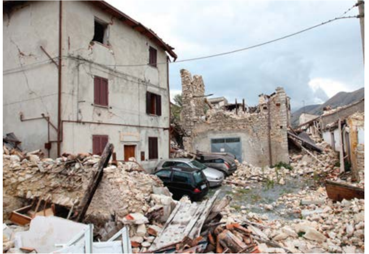
Danni del terremoto de L'Aquila, 2009
