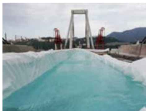
Foto 1. Una delle "piscine" sul viadotto (Fonte: http://www.commissario.ricostruzione.genova.it )
